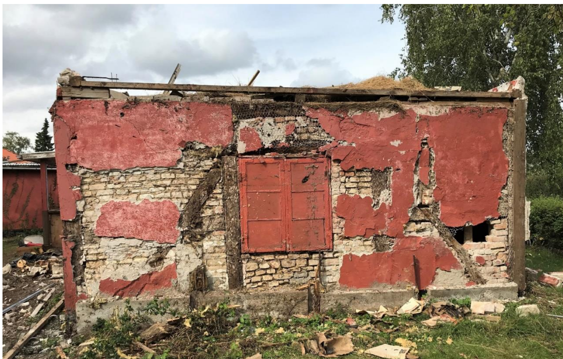
Figur 18. Sydgavl af Traktor Oles hus under nedrivningen, som blotlagde det oprindelige bindingsværkshus med tavl af ubrændte lersten. Vinduet gemte sig under pladebeklædningen og kunne ikke erkendes på skråfoto fra 1939. Vinduets hjørnebåndshængsel er typiske for perioden efter ca. 1850, så det sandsynliggør, at der har været et vindue, da husmand og væver Christen Christiansen beboede huset i 1855. Foto: Morten Stenak 2020.
