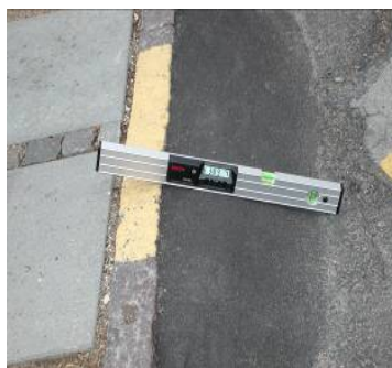
Rampe, som er for stejl
