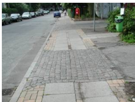
Gangbane afbrudt af brosten
