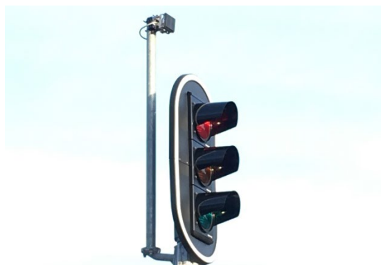
Figur 4: Radar (placeret i eksisterende signalmast) til detektering af trafikanter i et signalreguleret kryds.
